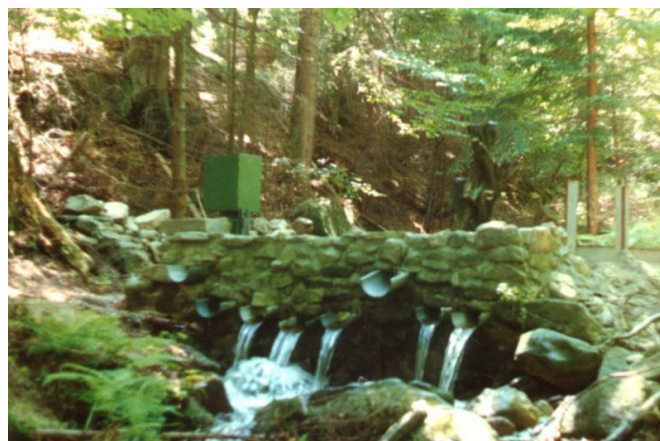
Zapora na Wilczym Potoku wybudowana w 1988 r. Stanowisko prezentowane podczas sesji terenowej dotyczącej erozji stoków w Karkonoszach (fot. M. Katrycz)
